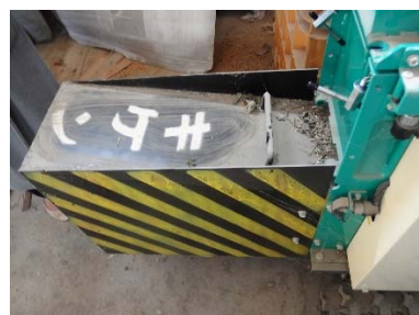
写真5 ブロワに手が届かないよう、 大きめの安全ガード（トラ柄） が設置された排出口
