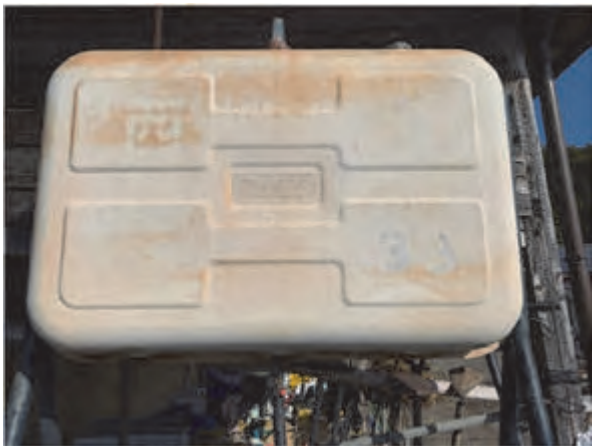
軽油タンクの火気厳禁の未表示<前>
