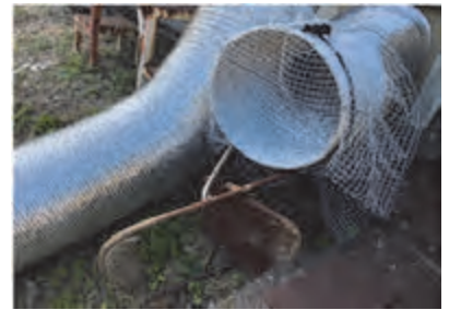
排気ダクトの侵入防止
