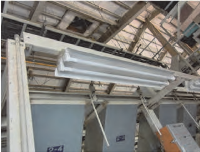
精揉機の上部の蛍光灯を飛散防止 LED に交換
