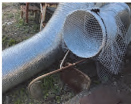
排気ダクトの侵入防止
